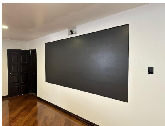
Figura 12 Equipos de la sala de sesiones del Estado Mayor General FAE.
